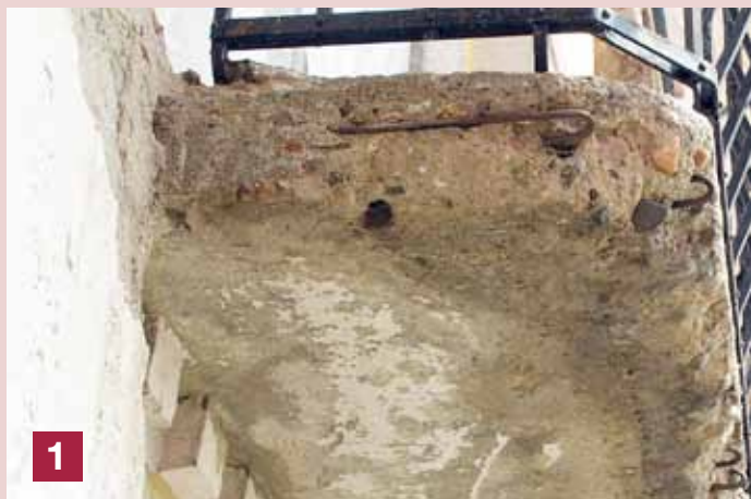
1 Балкон с обрушвания, корозирала армировка и парапет, корозирал в участъците на закотвяне в пода.
