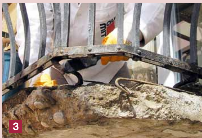
3 Внимателно се почиства бетонът около арматурата до достигане на некорозирал участък (т.е. да не е нарушено сцеплението между армировката и бетона). Почистването от корозия става с телена четка (и/или с ръждопреобразувател) – до блясък. При по-големи площи почистването на арматурата се извършва с водоструен апарат, с добавяне на абразив.
